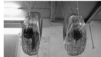
Ventilatoren sollen auf Züge reagieren. PD
